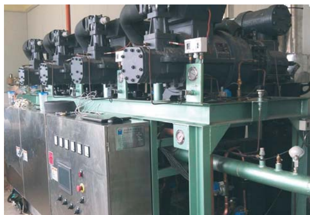
Многокомпрессорная низкотемпературная централь
